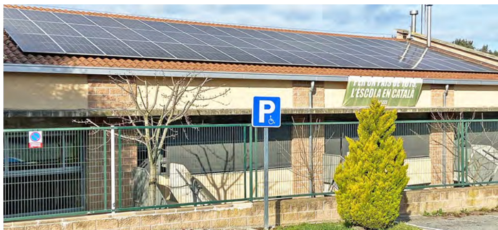
Teulada fotovoltaica a l'Escola Anton Busquets i Punset (fot. Ajuntament de Calders)
