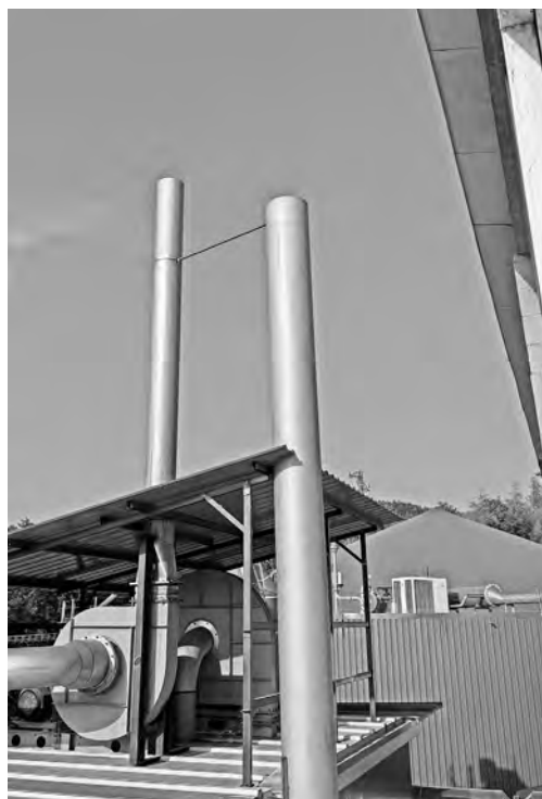
Xemeneies dels motors de cogeneració
