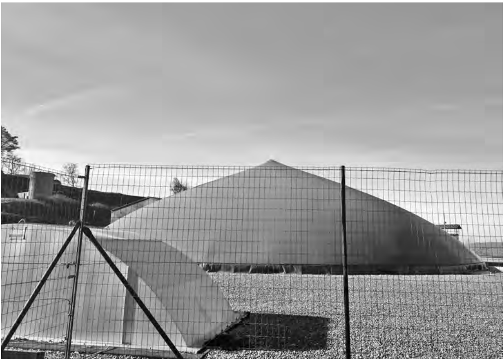
Cúpula del digestor on s'emmagatzema el biogàs hermèticament tancat
